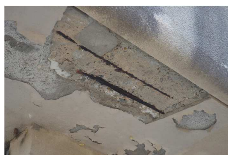
コンクリートの剥落
