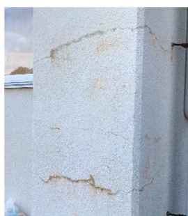
錆汁を伴うひび割れ
