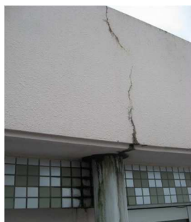
構造躯体のひび割れ
