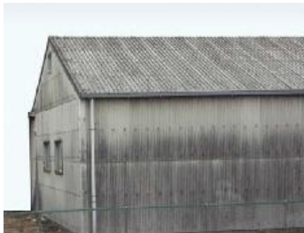
石綿含有吹付けロックウール
