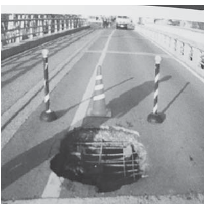
道路抜け落ち事例、目に見えない内部の劣化
