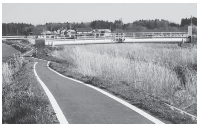
亀裂が見られる箇所（小岩戸地内）
